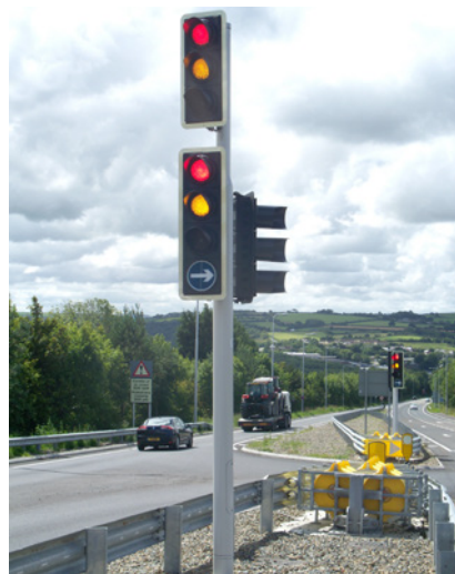
Traffic Signal Pole (Punch 6m 165/145)
